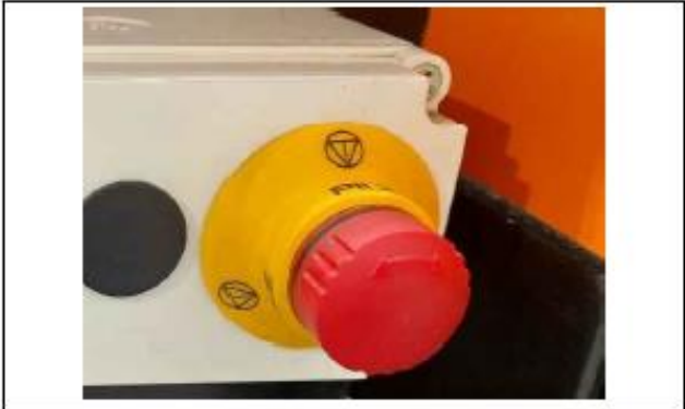
Foto 27 Perigo 2.1, Botão de emergência (Painel de comando)
