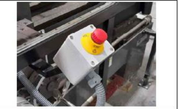
Foto 28 Perigo 2.1, Botão de emergência (Carro de ferramenta)
